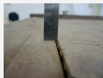
Particolare perdita di planarità lungo le fessurazioni.
